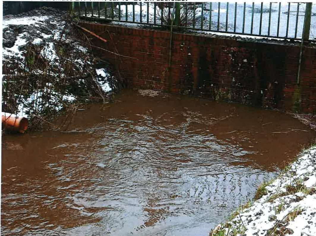
Bild Nr. 1 Durchlass DN 1000, ca. 15 -20 cm überstaut
