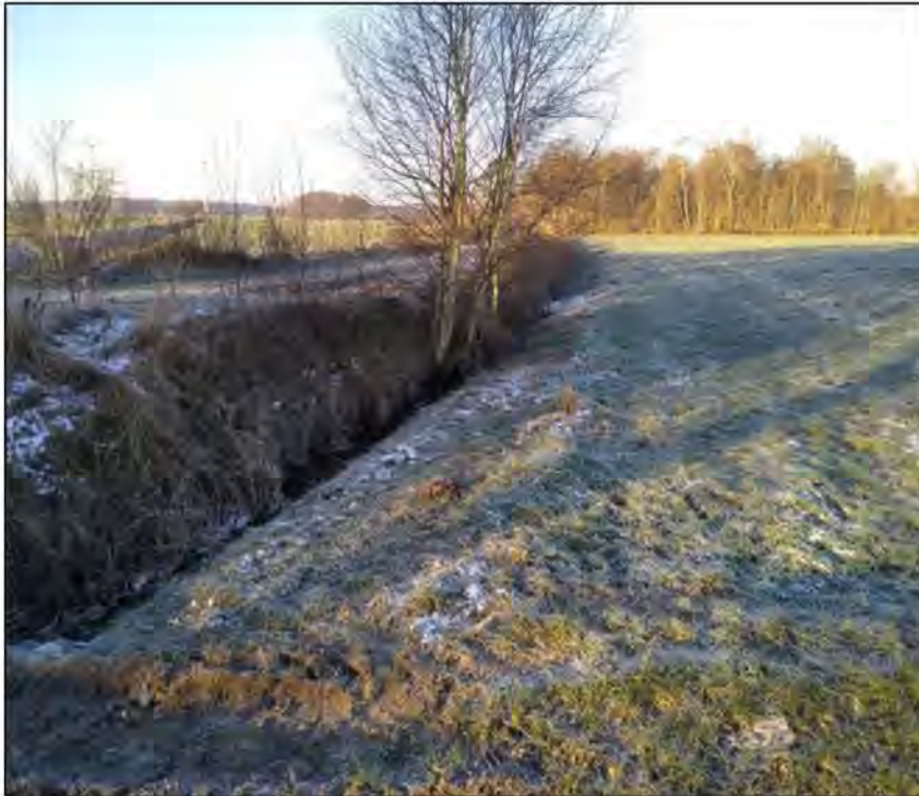
Abbildung 10: Blick von der Einfahrt nach Westen: Abgesenkte Oberfläche auf den Wegeseitengraben zu.
