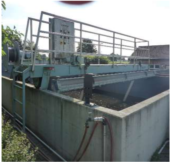
Räumerbrücke Nachklärbecken 1, Baujahr 1970
