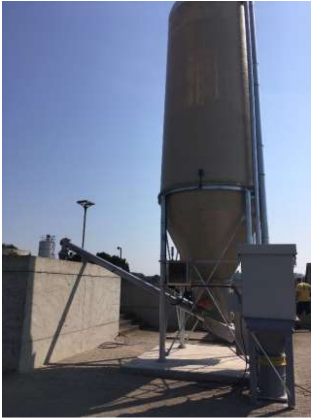
Kreidesilo am Kontaktbecken
